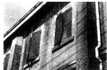
爆風により変形した鉄扉
